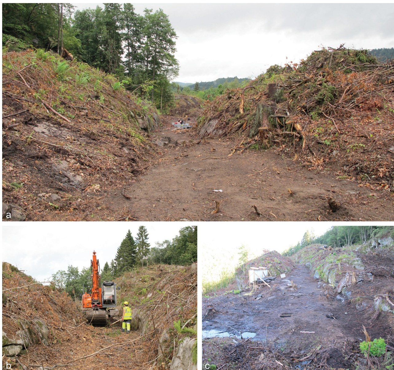
Figur 14.3.2. Oversiktsfoto over Langangen Vestgård 2: (a) lokaliteten sett mot sør, (b) lokaliteten avtorvøs ved Stine Melvold, sett mot nord, (c) lokaliteten sett mot nord, vått område i forkant.
