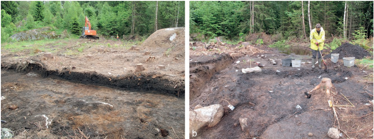
Figur 4.3. (a) Nedre Hobekk 2 sett mot sørøst. I forgrunnen ses snittet av kullmilen. I bakgrunnen avtorves myrområdet med grave-maskin. (b) Ragnbild H. Nergaard graver bort et forstyrret lag med kull vest på lokaliteten. Myrområdet ses i bakgrunnen.
